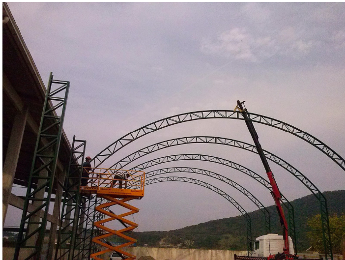
Figura 20 – Construção da cobertura da EB Luiz Cândido da Luz (Crédito: Marise Matos Gonçalves; Fonte: http://comunicaluizcandido.blogspot.com.br )
